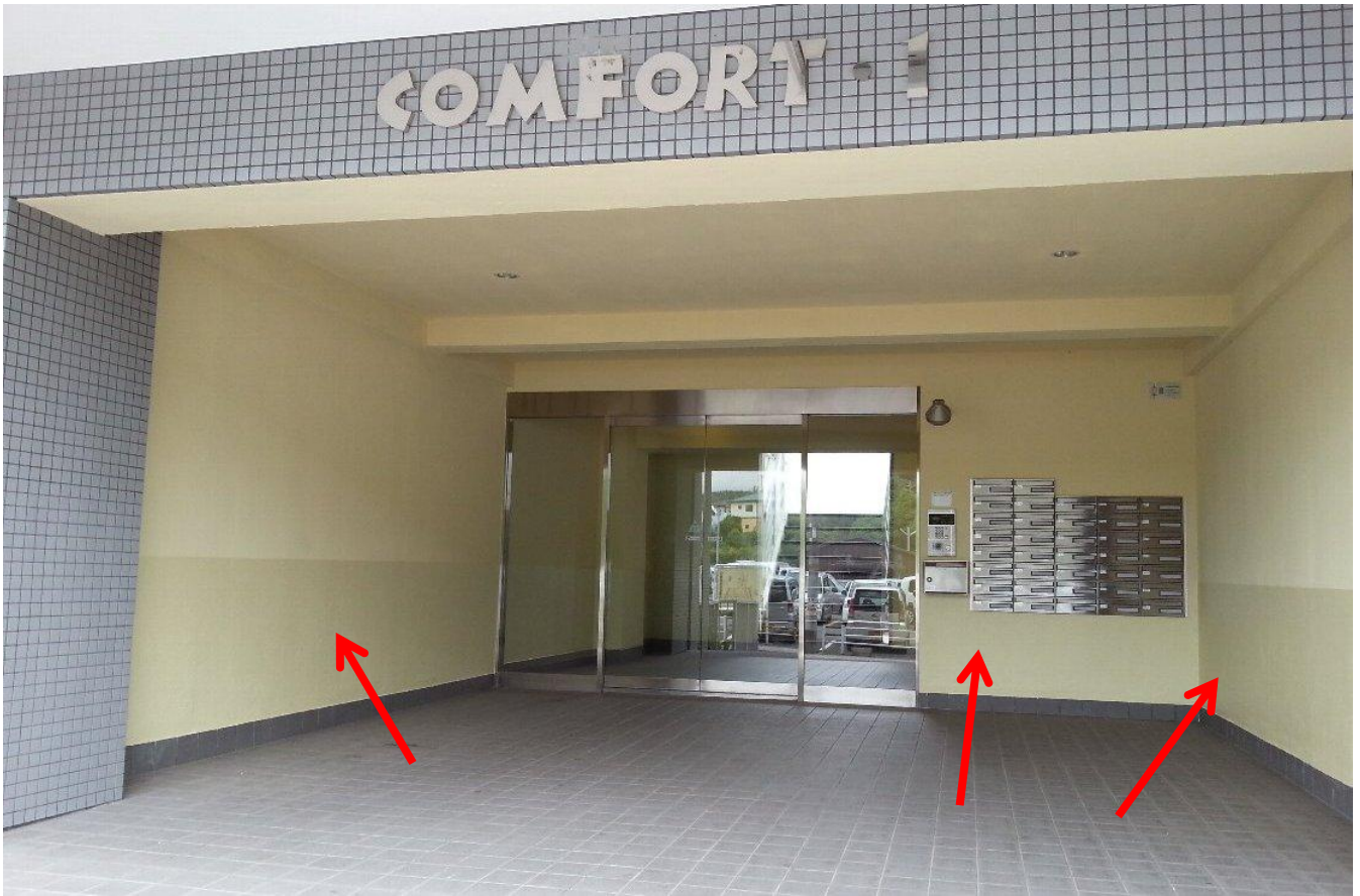
マンション正面入り口 壁面両サイドの汚れ防止(色の濃い部分)
