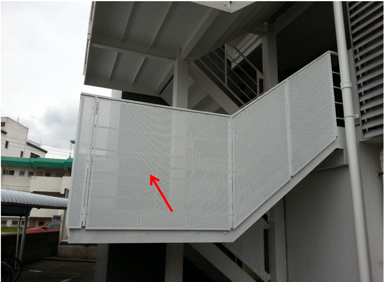
マンション非常階段侵入防止板の汚れ・落書き防止
